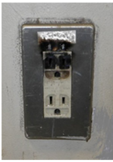
コンセントのこげ跡
